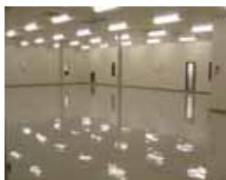
本社クリーンルーム
